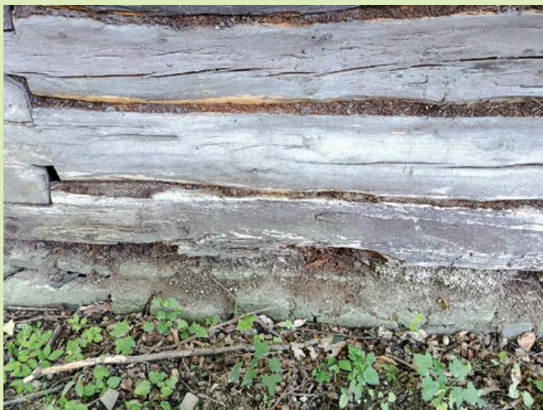
Detail destrukce dřeva napadeného dřevokazným hmyzem a biotickými škůdci, rozpad způsobuje také zub času a povětrnostní vlivy.
